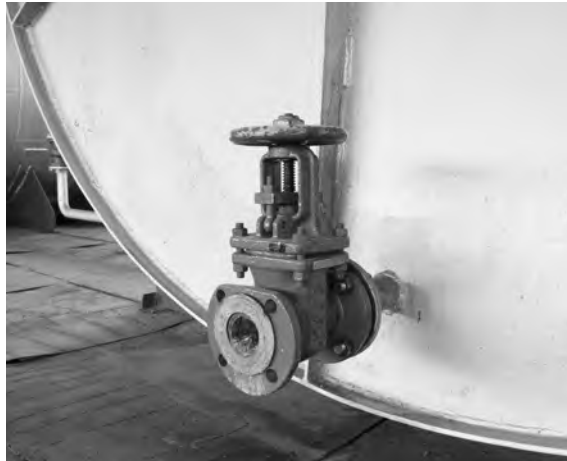
รูปที่ 1.14 แสดงวาล์วระบายน้ำที่ถังพักลม
