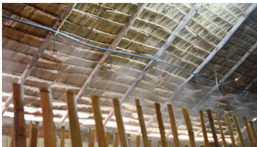
ติดสปริงเกลอร์ระบบน้ำฝอยปรับอุณหภูมิในโรงเรียน
