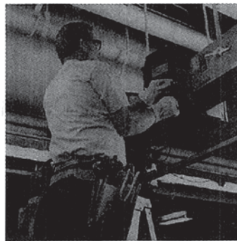
(ข) ช่างเทคนิคกำลังตรวจสอบระบบไฟฟ้า
